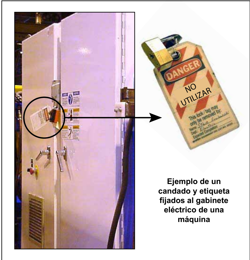
Figura 6-1: Bloqueo/etiquetado en el gabinete eléctrico principal
